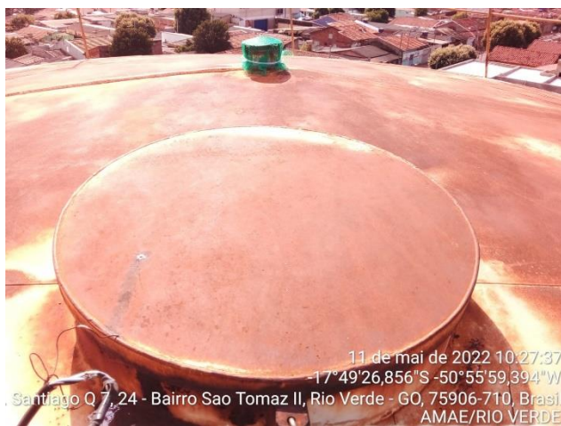
Autor: AMAE/RIO VERDE Descrição: Processo de corrosão moderada na estrutura do REL.
