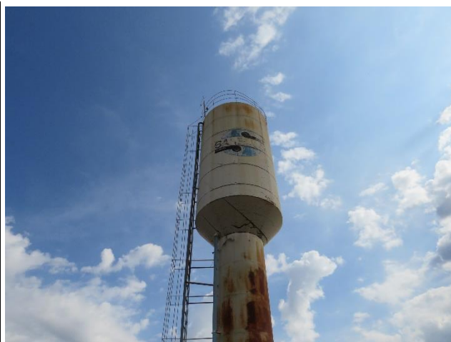
Autor: AMAE/RIO VERDE Descrição: Processo de corrosão moderada na estrutura do REL.
